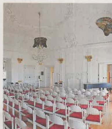
Das Holz der Decke im Festsaal war von Würmern zerfressen.
